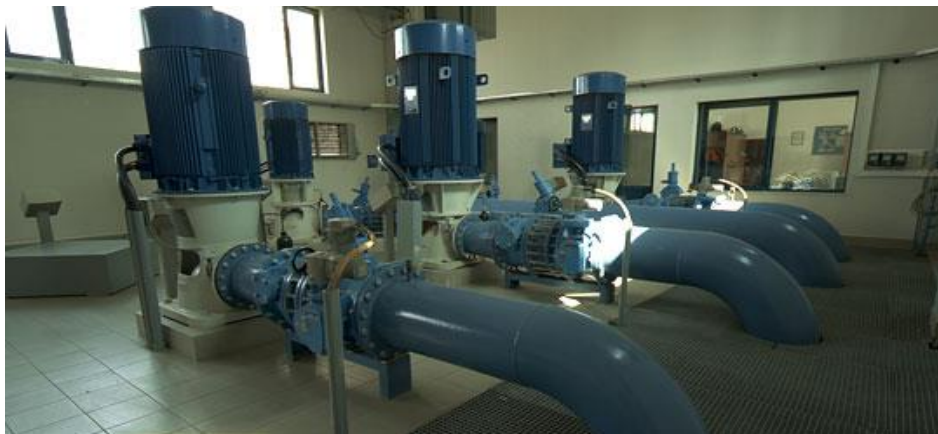
Slika 5. Pumpe za tlačenje vode u gradsku vodovodnu mrežu (Izvor: autor)
