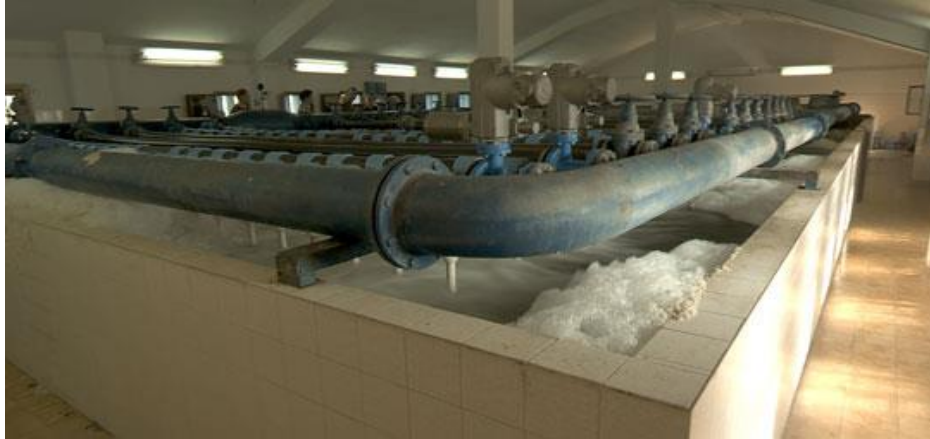
Slika 3. Bazeni aeracije (Izvor: autor)
