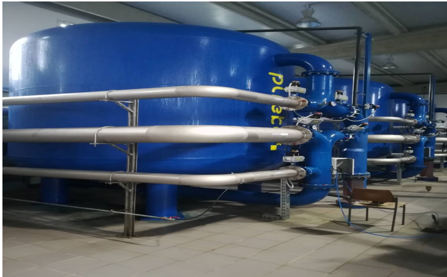
Slika 9. Filter i pneumatski ventili (Izvor: autor)
