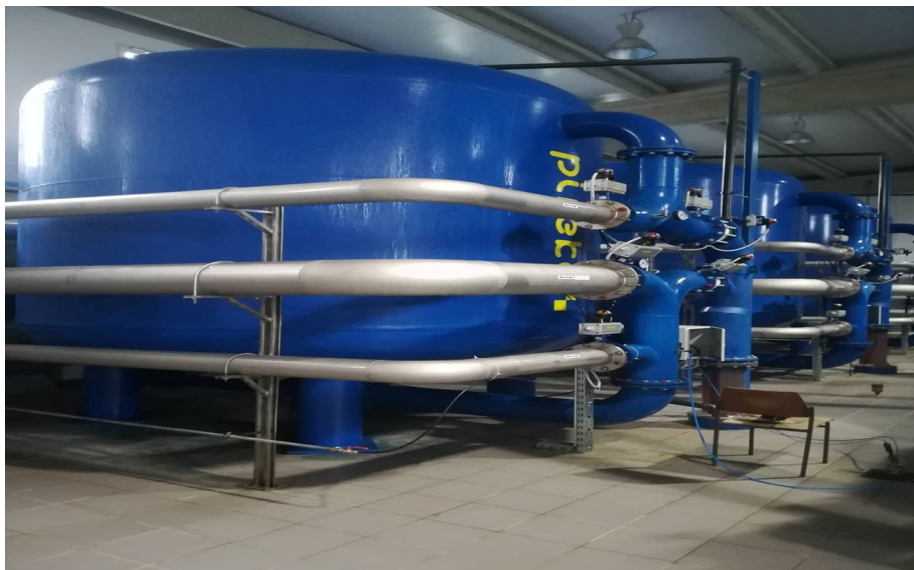
Slika 9. Filter i pneumatski ventili (Izvor: autor)
