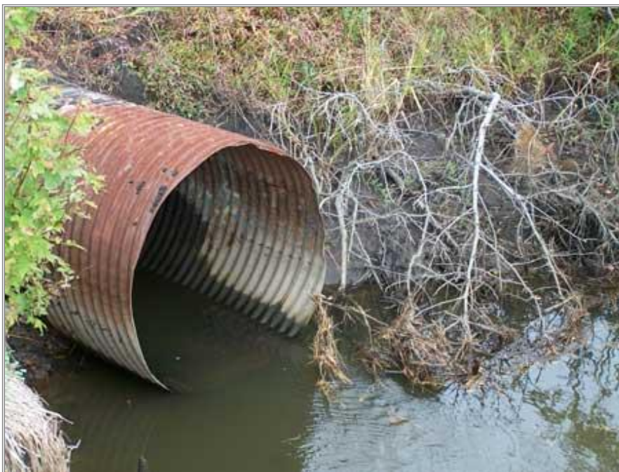
Slika 4. Prikaz neadekvatnih objekata za odvodnju otpadnih voda (Anonymus 1, 17.05.2016., url).
