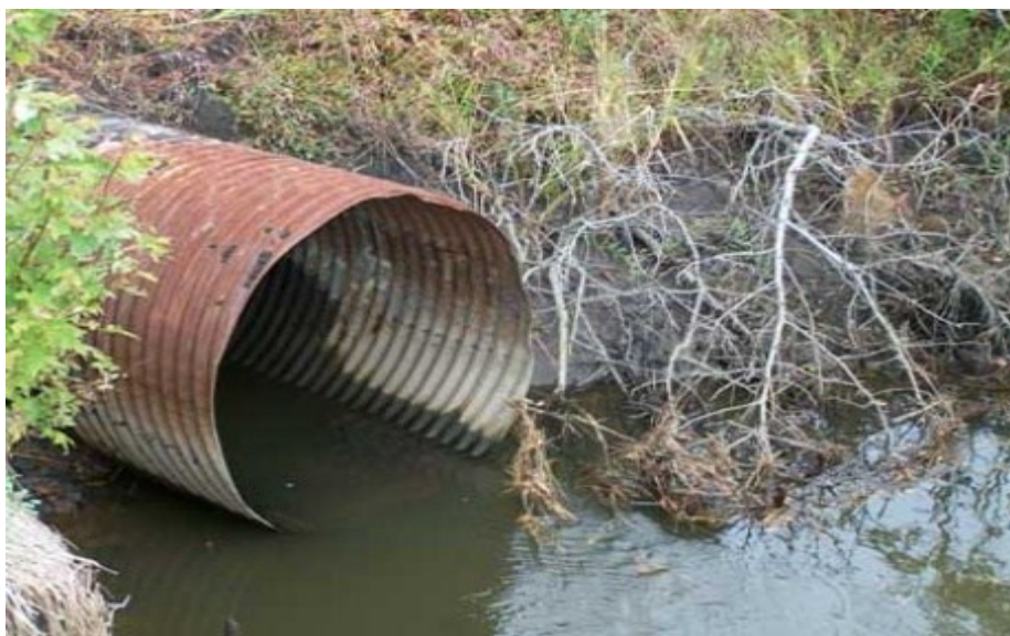
Slika 1. Prikaz neadekvatnih objekata za odvodnju otpadnih voda (Anonymus_6, 03.06.2016. url)
